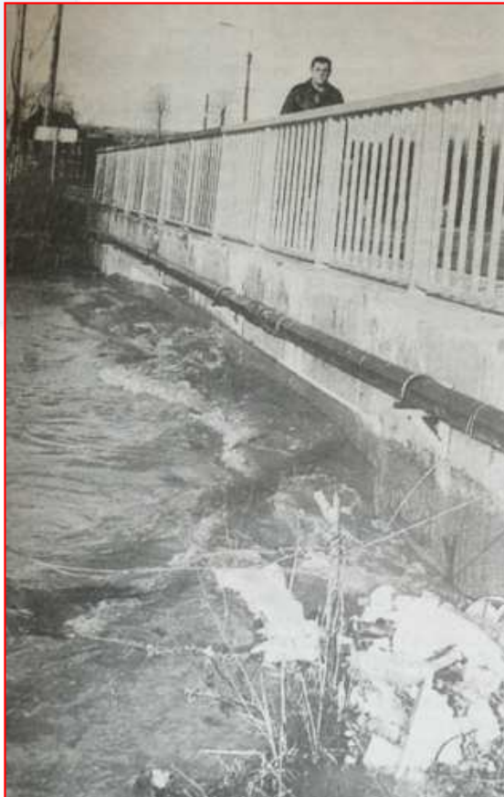
La voûte du pont de la rue Paul-Obry, submergée par la crue.
